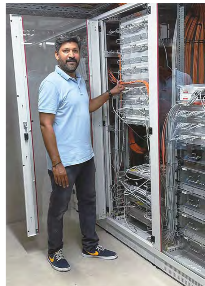
Sanish Parapurathu ist Teamleiter Support & Infrastruktur in der ICT-Abteilung von SRZ.
